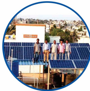
Solar System (सौर उर्जा प्रकल्प)
