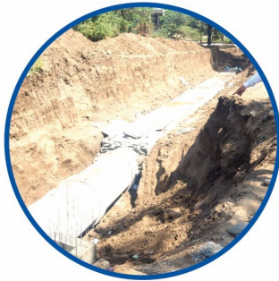
Sewerage (भुमीगत गटार)
